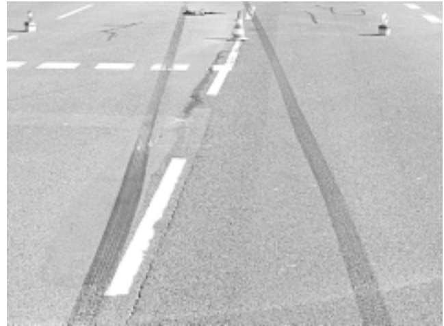
Abb. 4.3.5: Bremsblockierspur verläuft über eine Flickstelle
